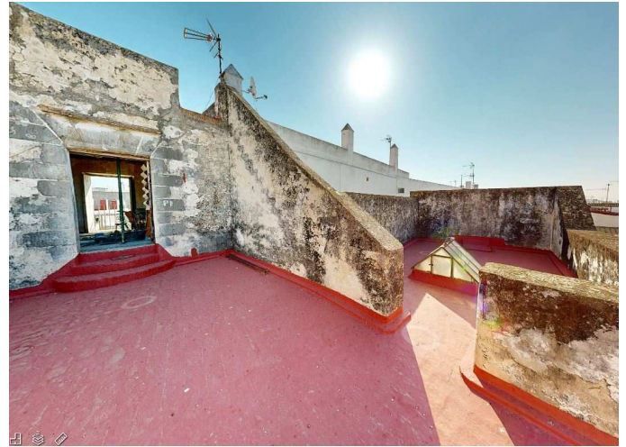
Fachada del módulo del edificio en planta segunda dónde se observan en medianera derecha de acceso al módulo los vestigios de la escalera preexistente de acceso a planta cubierta.
