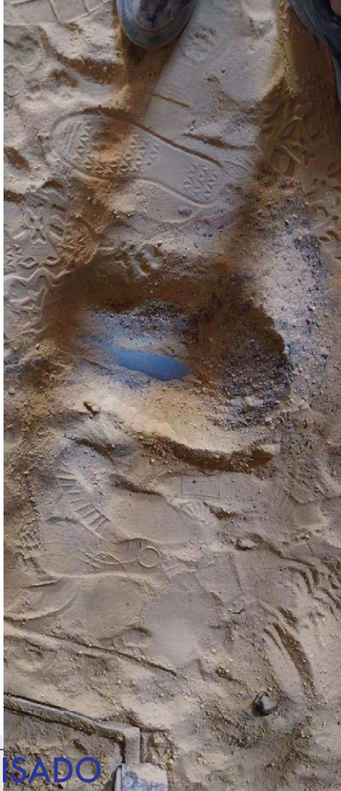
Profundidad del colector, prácticamente tangente con el solado
