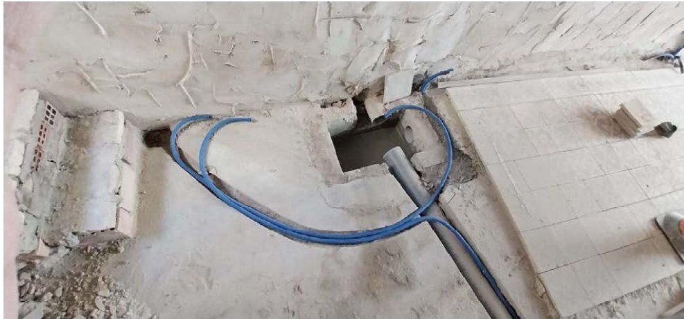
Arqueta general y colector de conexión en la zona superior de la misma.
