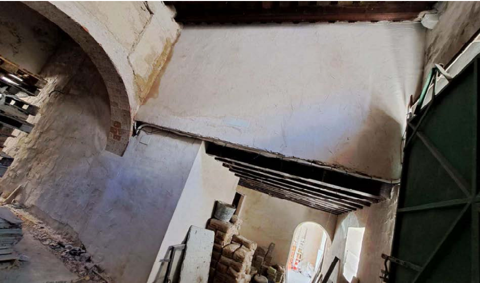
Fotografía N26. Distribuidor central y zona de usuarios.
