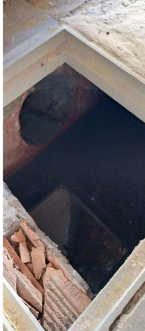
Profundidad arqueta existente donde se observa que el colector está en la parte superior de la arqueta.
