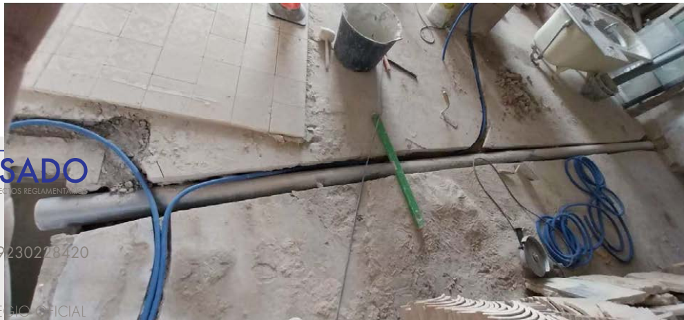
Arqueta general y colector de conexión en la zona superior de la misma.
